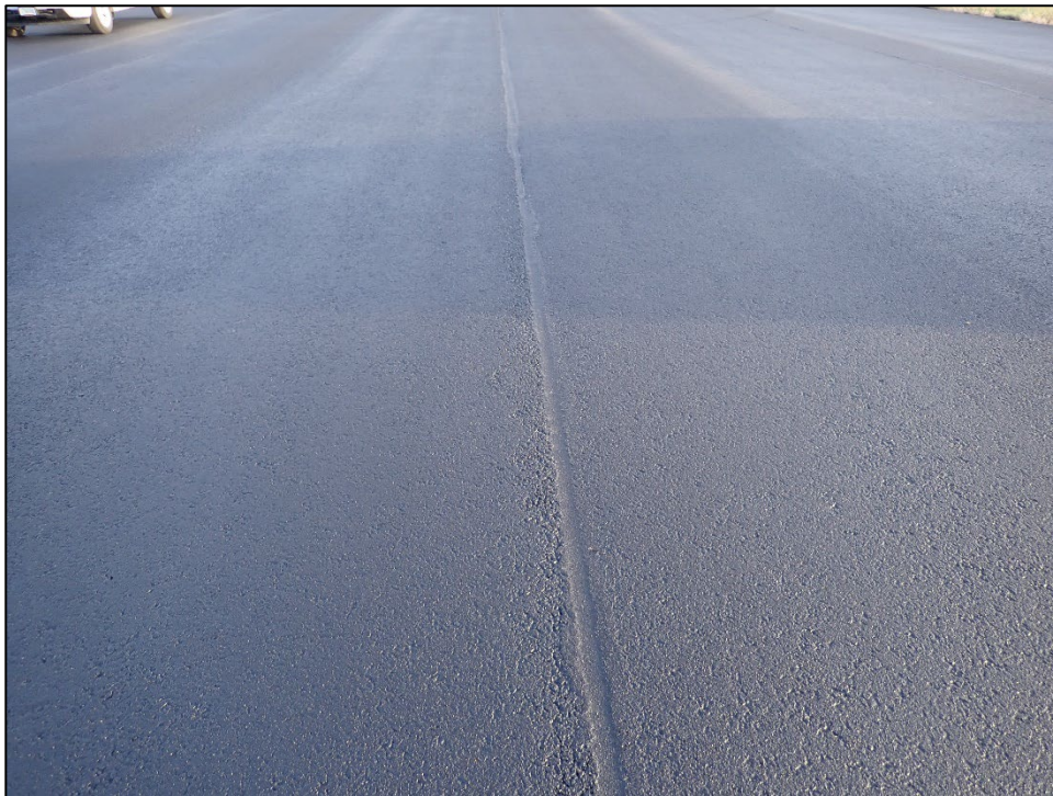
RW15-02-20: L&T Cracking
